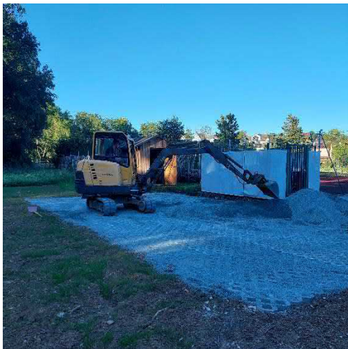
Hinter der Küche neben dem Tennisplatz wurde ein Wirtschaftshof für die Pächter angelegt.
