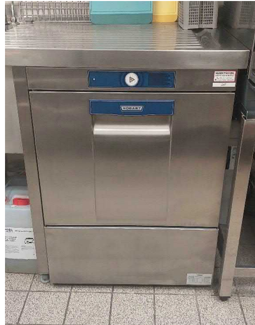
In der Küche wurde eine Industrie-spülmaschine angeschafft.
